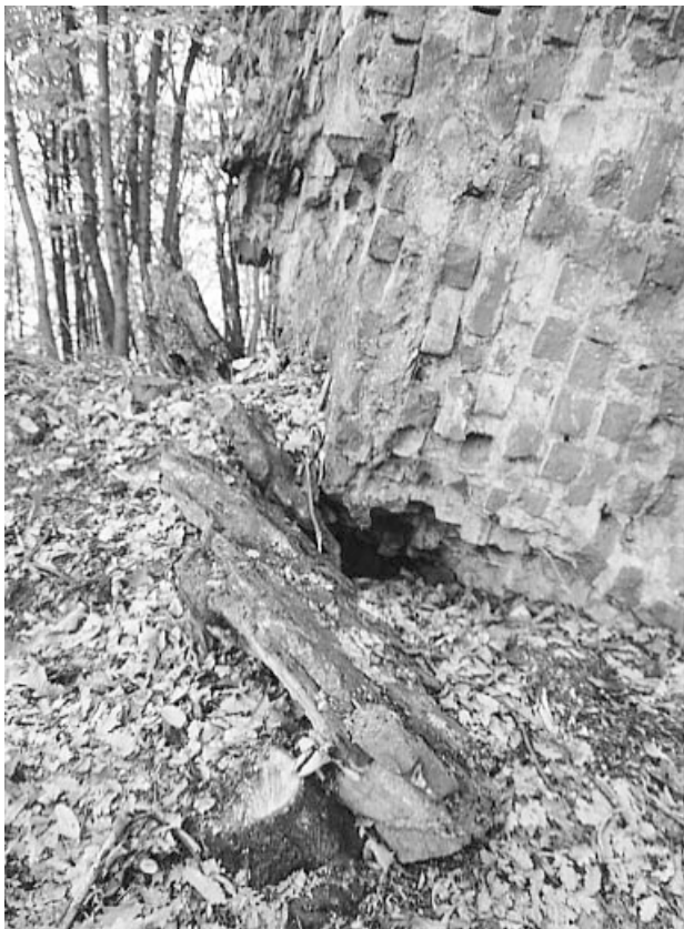
Fig. 12 – Particolare del perno di rotazione sul quale si è abbattuta la torre.
