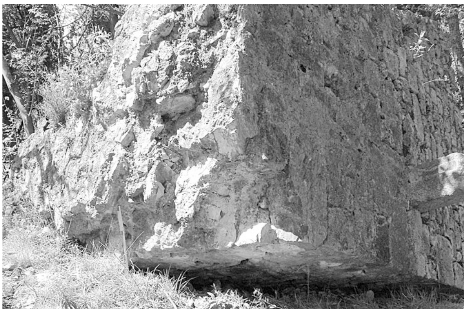
Fig. 8 – Montecastrese. Parte del troncone della torre abbattuta (nord-est); si nota la traccia dell'ampio scalzamento, taglio (2), effettuato sull'angolo.
